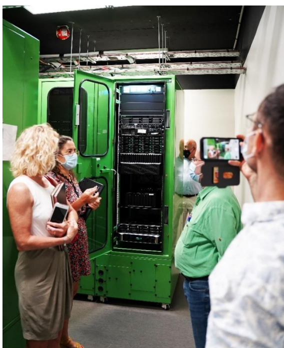
Visite de la salle des serveurs (data center) installée à l'UNC.
