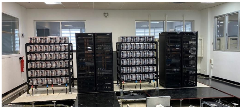
Site d'atterrage de Nouville : installation des baies d'énergie secondaire 48 V
